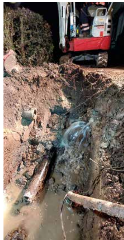
Rohrbruch beim Seniorenwohnheim
