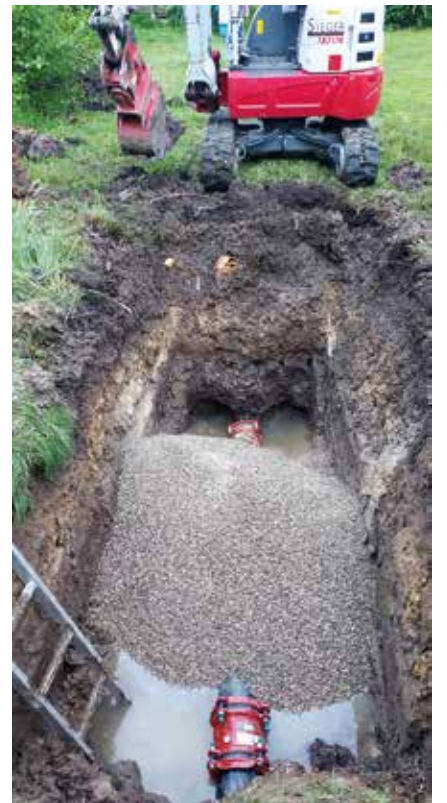
Und wieder ein Rohrbruch...
