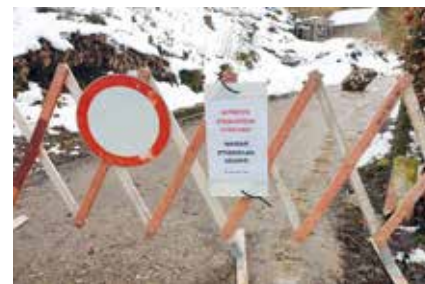
...insgesamt 5 m 3 Felsbrocken lösten sich, der Weg ist zwischenzeitlich wieder freigegeben
